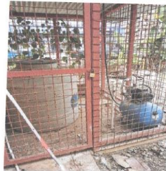
Bomba de agua
